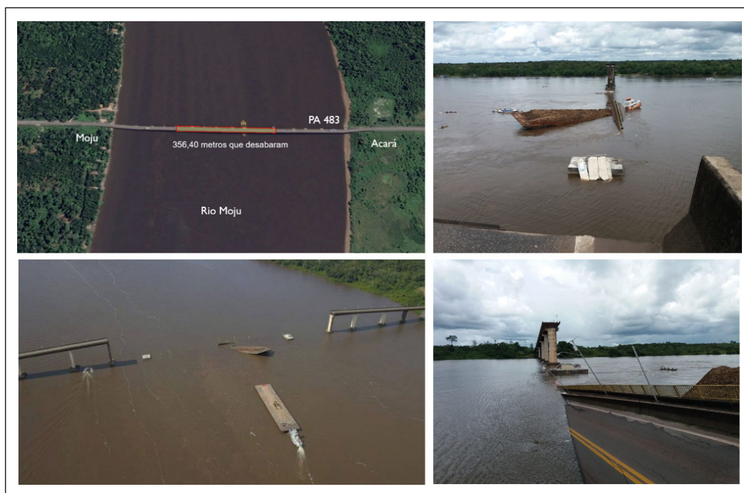
Figura 6. Desabamento de estrutura civil no nordeste do Pará. Fotos: Relatório geral CEDEC (2019).
