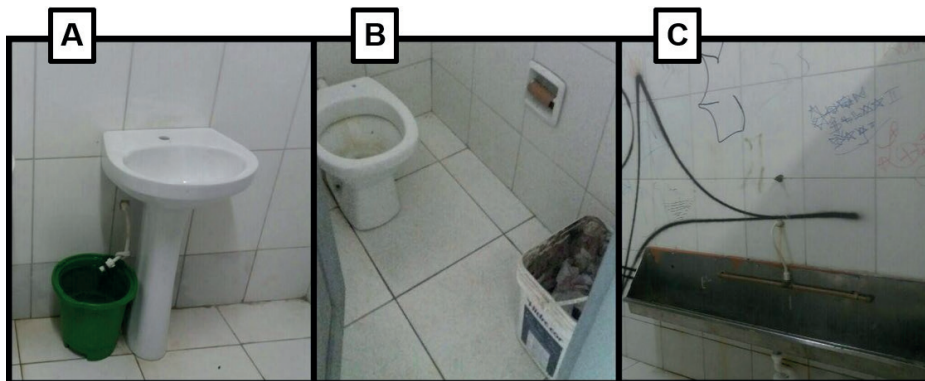
Figura 2: Má estrutura oferecida pelos banheiros da escola.
