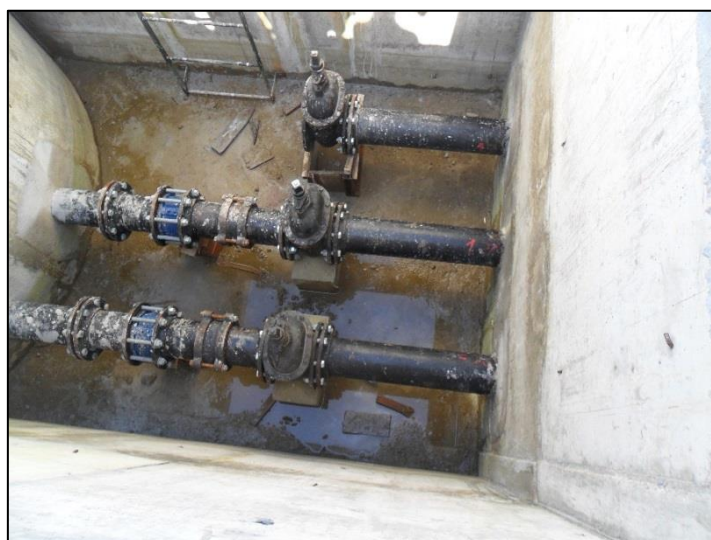
Figura 3: Estação Elevatória do Sistema de Esgotamento Sanitário do Município de Limoeiro do Norte.
