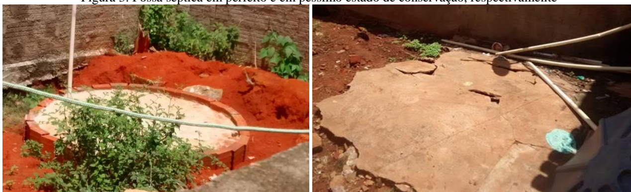
Figura 3: Fossa séptica em perfeito e em péssimo estado de conservação, respectivamente
