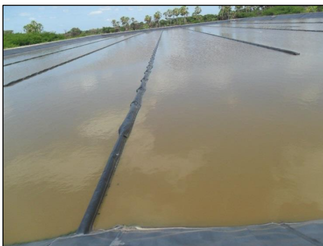
Figura 4: Estação de Tratamento de Esgoto do tipo Lagoa de Estabilização do Município de Limoeiro do Norte.
